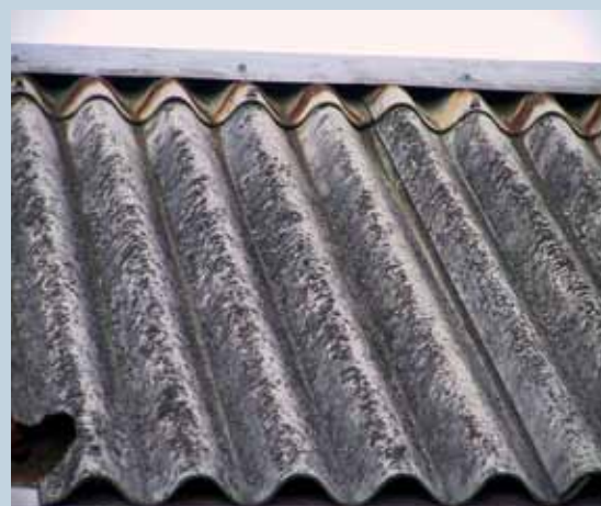
Bild 10 Oberflächlich verwitterte Asbestzementwellplatten [C.1]
